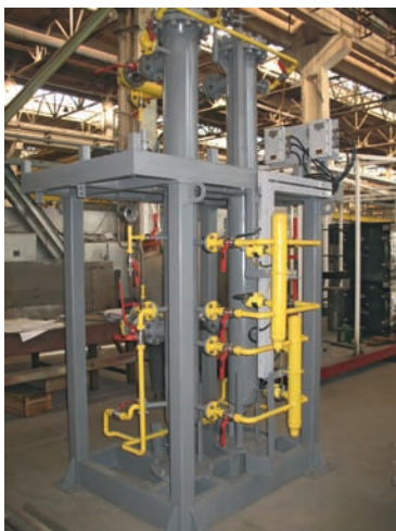
Блок фильтров подготовки газа
